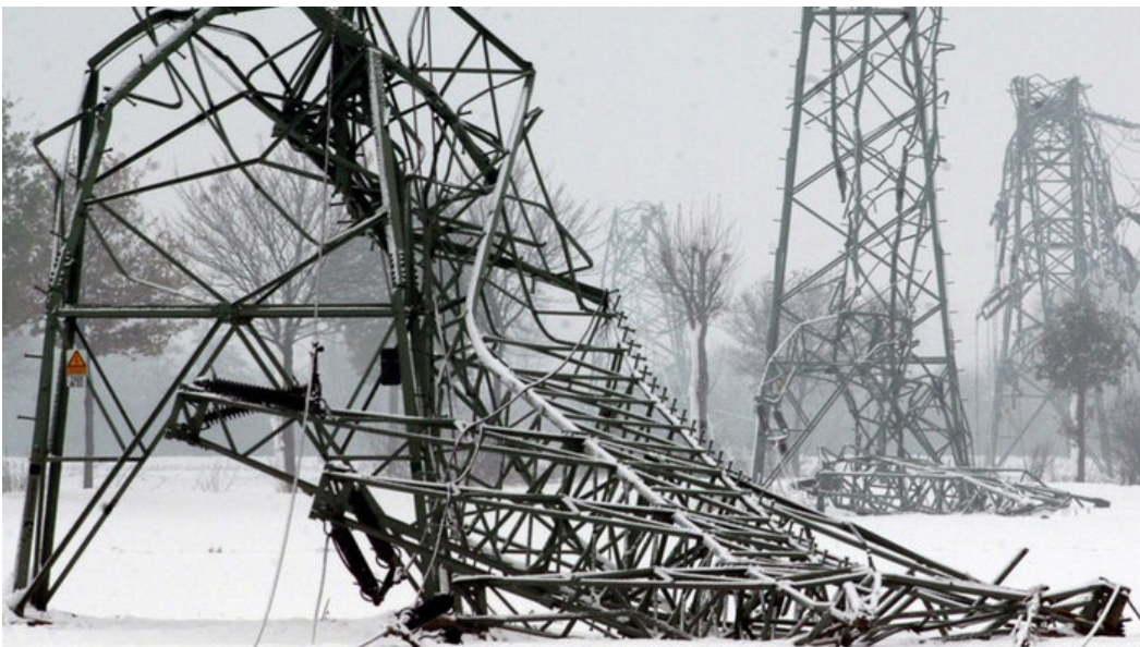
Bild 8: Typisches Schadensbild an den vom Eis überlasteten Hochspannungsmasten im Münsterland 2005 (Quelle. WDR)
