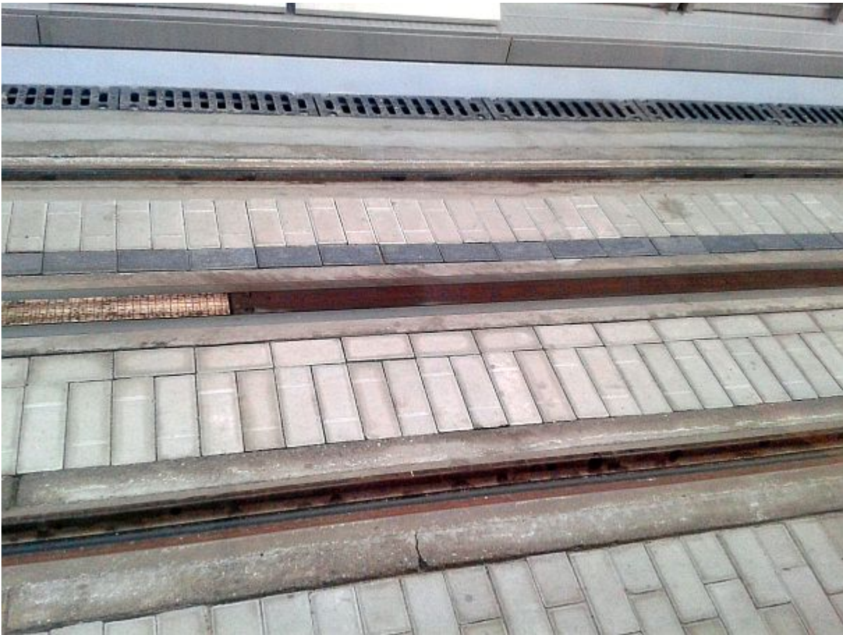
Demmig, Straßenbahn in Dubai, Stromband mit Isolierstellen an Übergängen
